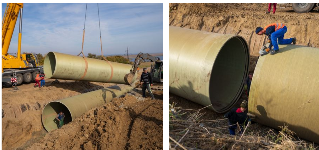
Fig. 37: Instalarea subterană standard a unui sistem de conducte uniaxiale de GRP/PAFSIN DN 2800
